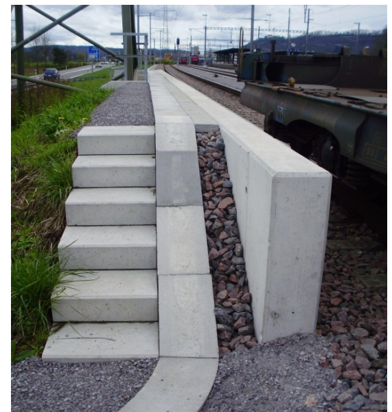
Gleis 39 Anprallschutz vor Hochspannungsmasten mit Kabelkanal und Bankett
